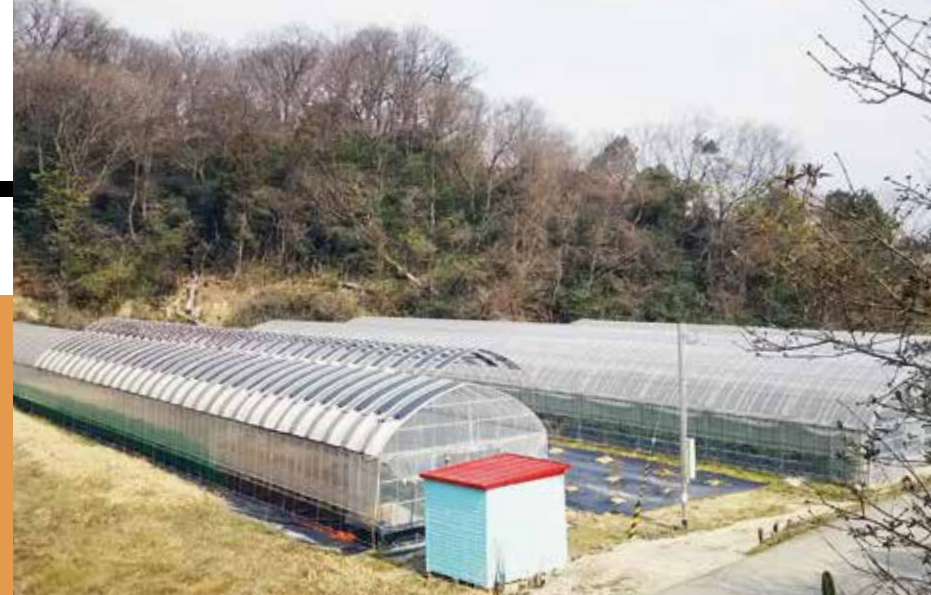
農業ハウスに設置した太陽光発電システム
