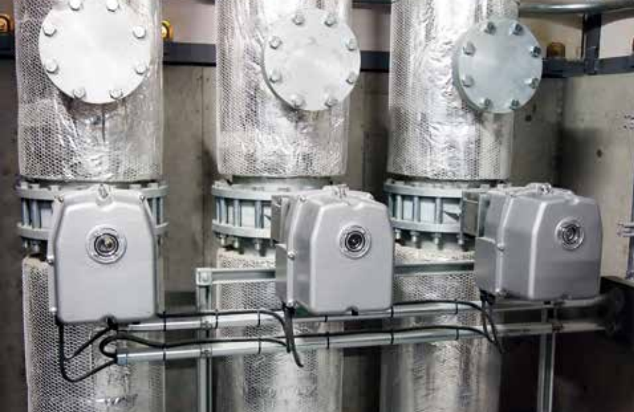
東京スカイツリーに設置されているキャパシタ雨水緊急遮断弁
